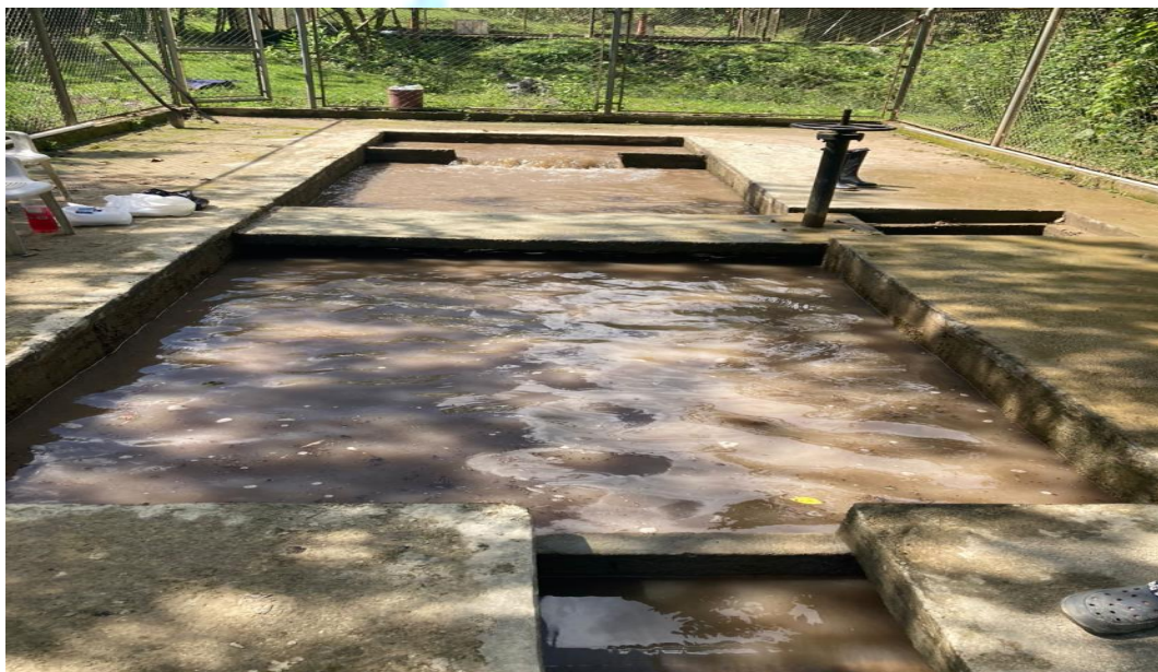
Segunda sección de desarenado y sedimentadores
